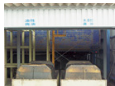
リサイクル用廃油分別タンク
