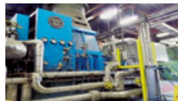
蒸気タービン発電機
