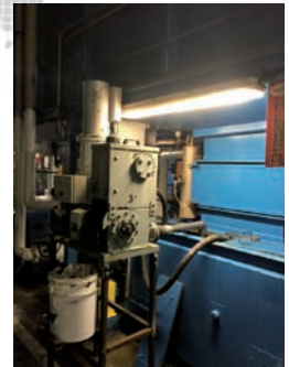
塗装工程の温水洗浄工程に設置された磁気フィルター
