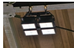
LED化した工場棟天井照明
