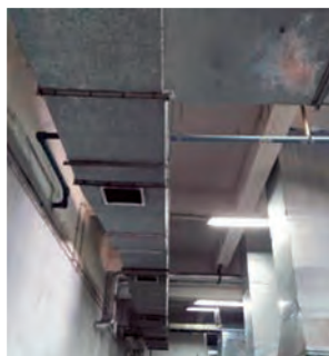
ファンのダクト
