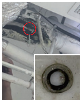
劣化したパッキン
